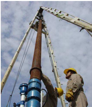
Avec la diminution de pertes et de consommation, les puits actuels suffisent pour l'alimentation de la population allongeant la viabilité du réseau jusqu'à 2035 – Photo Veolia
